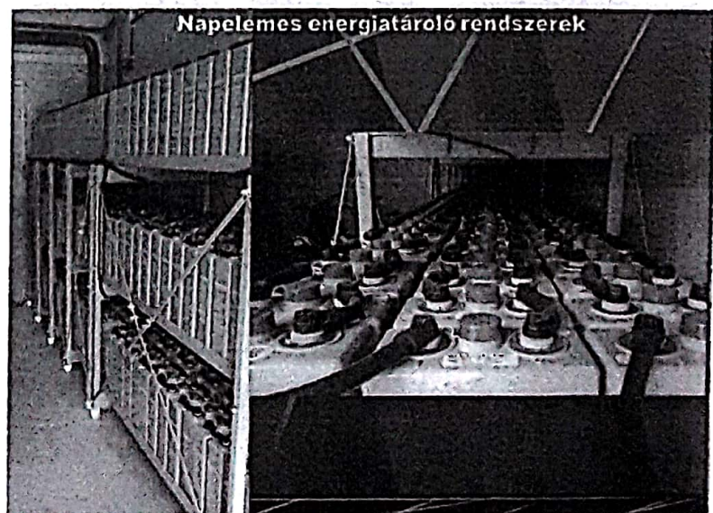
5. ábra: 30kVA-es UPS akkumulátortelege
